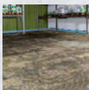
płyty betonowe bez hydroizolacji
