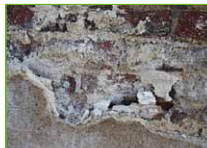
Typisk skade på grund af saltudblomstringer.
