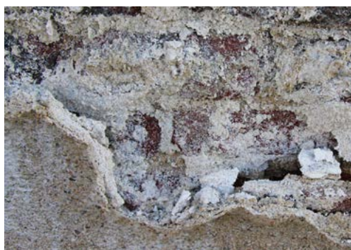
Daños típicos por eflorescencias salinas.
