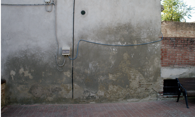
Cambio de color, reducción del aislamiento térmico.
