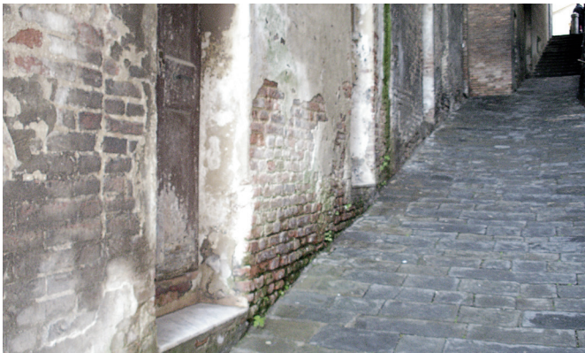
Destrucción del enlucido y las juntas de mortero.
