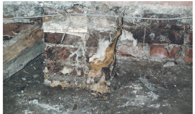
Desarrollo de moho y daños en la estructura del tejido.
