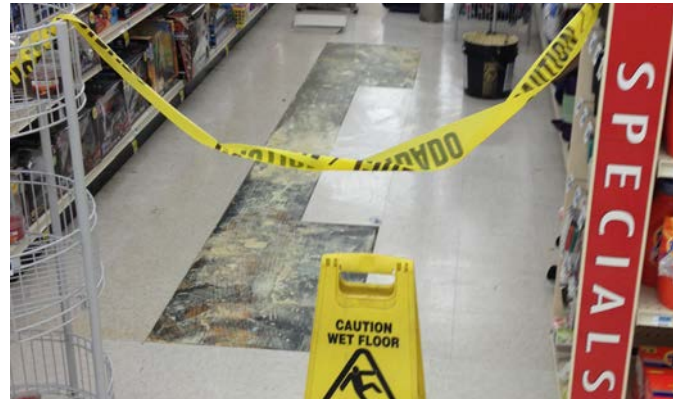
... y provoca tiempos de inactividad y elevados costes de reparación.
