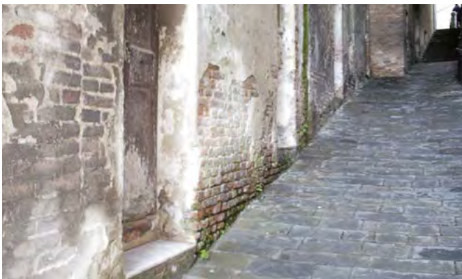
Zerstörung des Putzes und der Mörtelfugen
