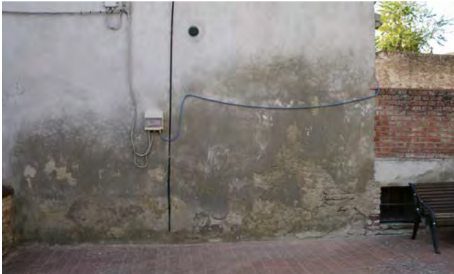
Veränderung der Farbe, Reduzierung der Wärmedämmung
