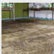
nicht abgedichtete Betonböden
