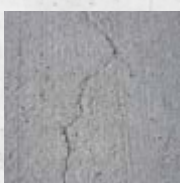
dringt in feinste Risse ein
