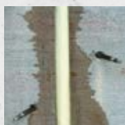
bildet Schaum in feuchten Rissen
