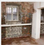
bei feuchtem Mauerwerk
