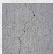
dringt in feinste Risse ein
