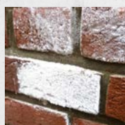
gegen Salz- ausblühungen
