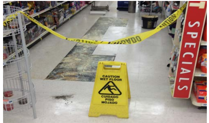
...und verursacht Ausfallzeiten sowie hohe Reparaturkosten
