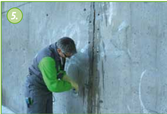
Der Riss wird vorgenässt.
