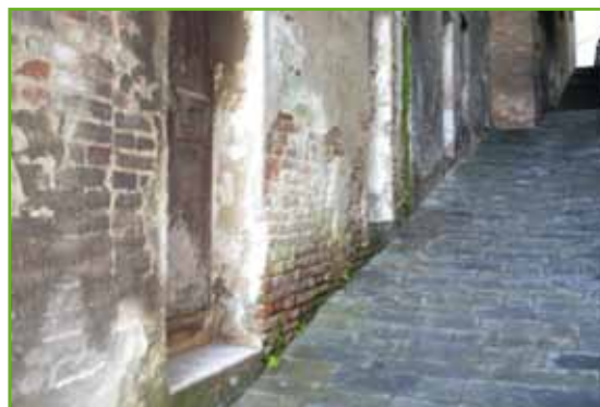
Zerstörung des Putzes und der Mörtelfugen
