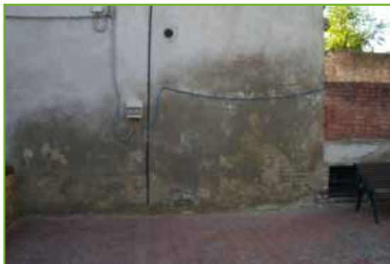
Veränderung der Farbe, Reduzierung der Wärmedämmung
