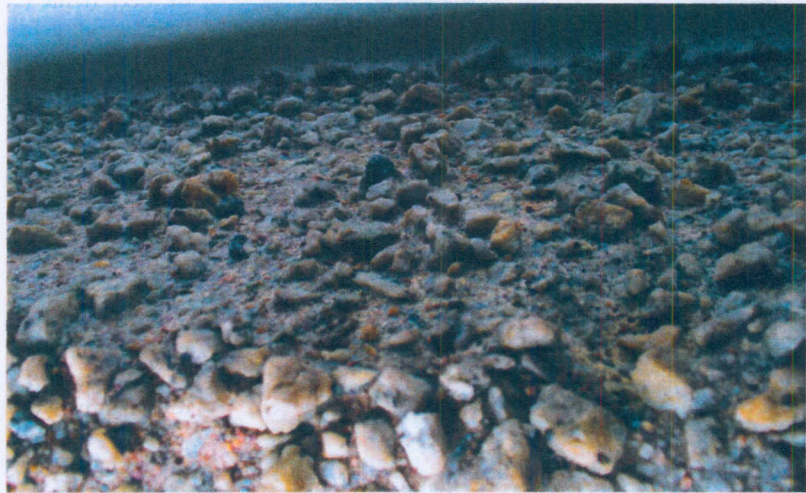
Lösender Angriff durch Säuren: Die Zuschlagstoffe des Betons liegen frei.
