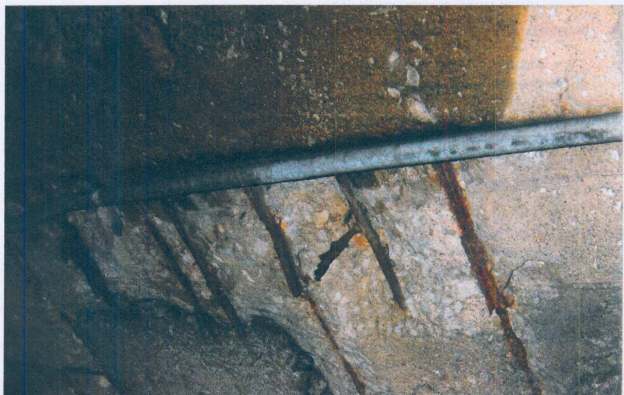
Betonkorrosion und Korrosion des Bewehrungsstahls
